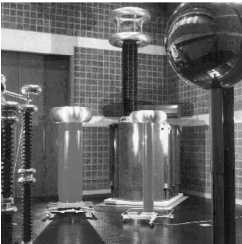
Bild 6.2.1-1: 500 kV/ 125 kVA Prüftransformator in Kesselbauweise mit Porzellan durchführung im Hochspannungsprüffeld der FH Würzburg-Schweinfurt.
